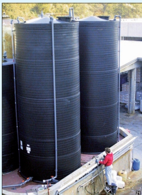
Serbatoi in bacino di cemento per stoccaggio acido fosforico 75% (capacità cad 50.000 litri, Ø 3.000 mm, h 7500 mm)
